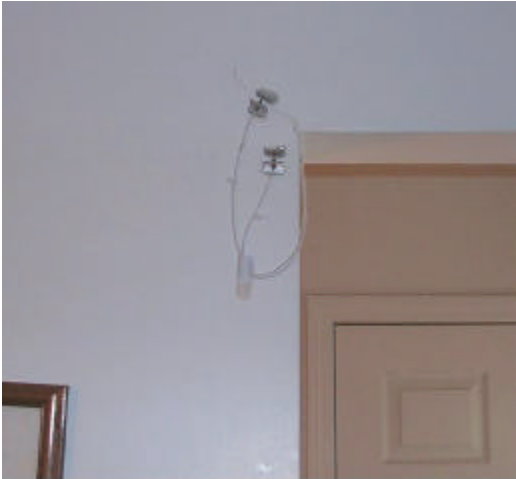
a) Indoor Bedroom Crack
